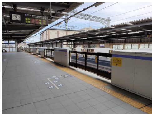
図. 転落防止用ホーム柵の設置例 (梅小路京都西駅)
